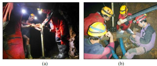
Gambar 3. (a) Pelepasan Pompa Submersible Kapasitas 1,5 HP dan (b) Pemasangan Pompa Submersible Kapasitas 2 HP di Dalam Goa Suruh (Dokumentasi Peneliti, 2014).
