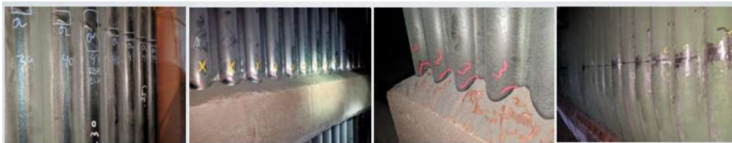
Inlet siklon pada backwall bagian atas
