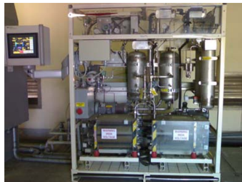
Gambar 2. Bentuk Fisik Hidrogen Generator (HMXT-200 Generator)
